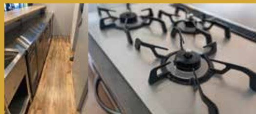
キッチン設備
